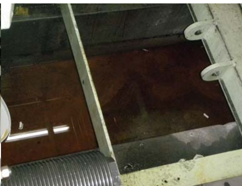
B号機 オイル溜まりが発生
