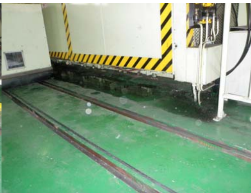
B号機 機械下にオイル漏れ
