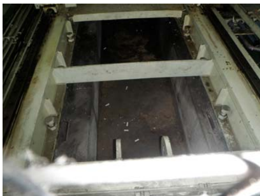
A号機 オイル溜まりが解消し、乾いた状態
